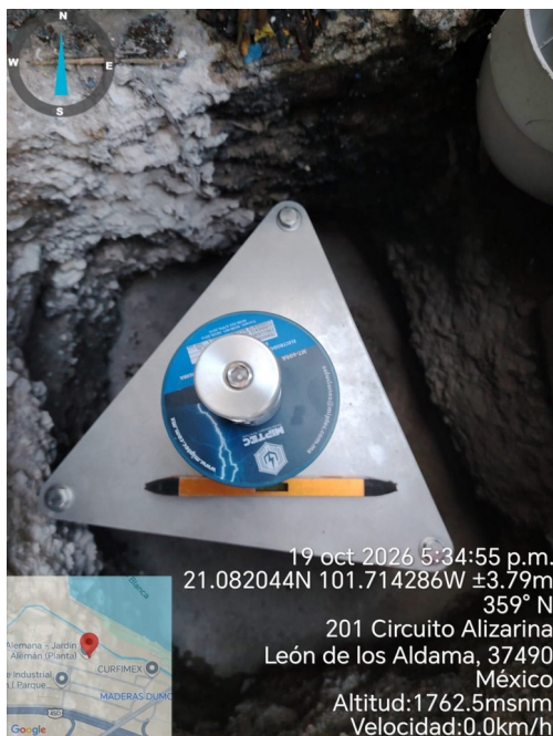
Electrodo magnetoactivo MT-600A instalado, orientado y nivelado.
