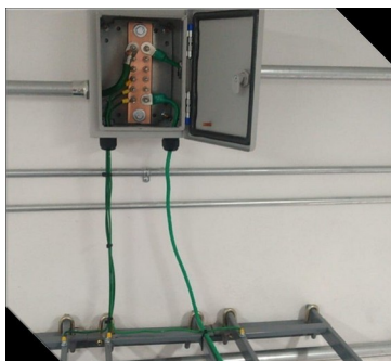
MT-GBN-01 instalada con derivaciones a tierra.
