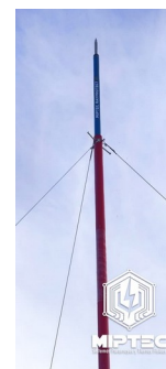
Sistema instalado sobre techo de nave industrial.
