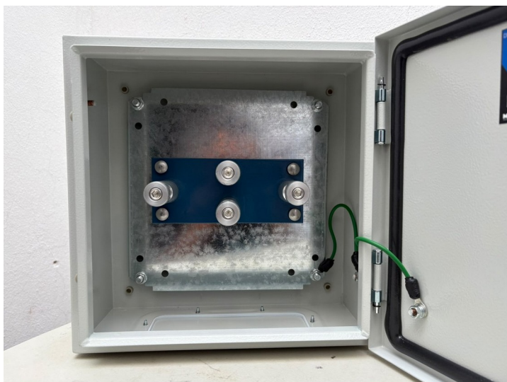
Acoplador sincronizador de admitancias del MT-RayProtect 03 en gabinete metálico NEMA.
